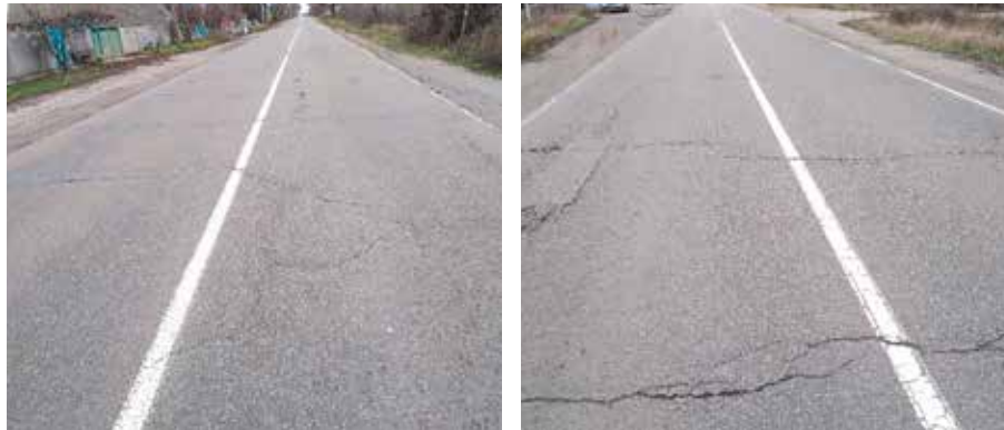
Рисунок 1.6 — Експлуатаційний стан дороги (J = 7 балів)
