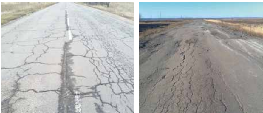
Рисунок 1.9 — Експлуатаційний стан дороги (J = 4 бали)
