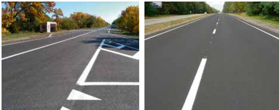
Рисунок 1.3 — Експлуатаційний стан дороги (J = 10 балів)
