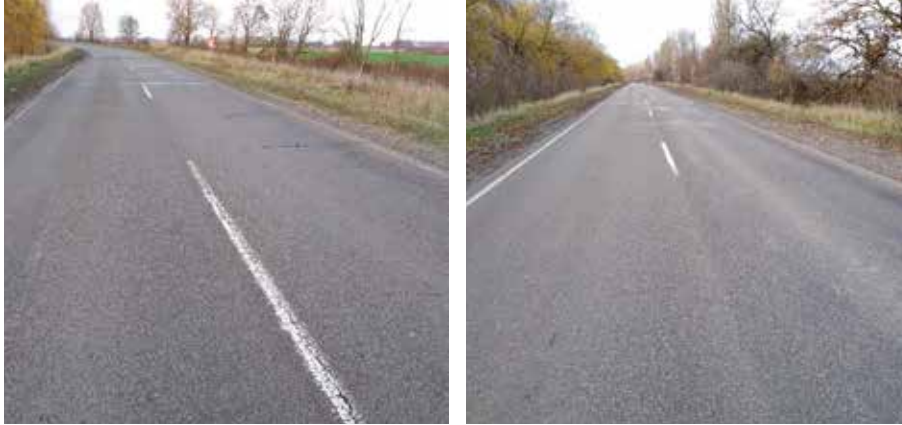
Рисунок 1.5 — Експлуатаційний стан дороги (J = 8 балів)
