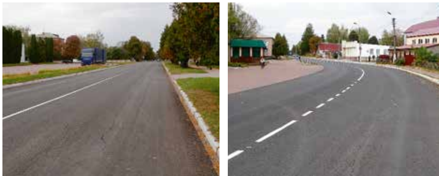
Рисунок 1.4 — Експлуатаційний стан дороги (J = 9 балів)
