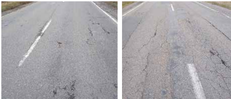
Рисунок 1.8 — Експлуатаційний стан дороги (J = 5 балів)
