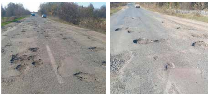
Рисунок 1.10 — Експлуатаційний стан дороги (J = 3 бали)
