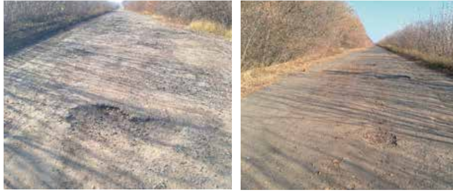
Рисунок 1.11 — Експлуатаційний стан дороги (J = 2 бали)
