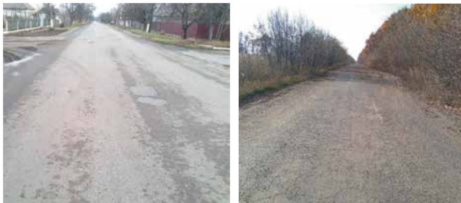
Рисунок 1.7 — Експлуатаційний стан дороги (J = 6 балів)
